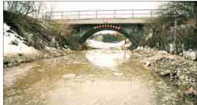
In dieser überfluteten Unterführung bei Geltendorf kam die gehbehinderte Renate S. (62) in den Eisfluten ums Leben. Foto: Gregor Feindt
